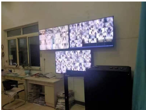
图 5.5 教学楼监控室
