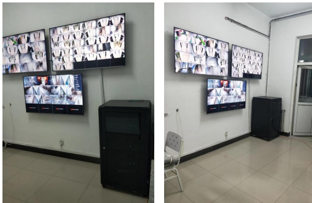
图 5.5 宿舍楼监控室
